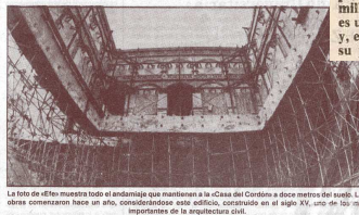
La foto de otro muestra todo el andamiaje que mantiene a la "Casa del Cordón" a doce metros del suelo. Las obras comenzaron hace un año, considerándose este edificio, construido en el siglo XV, uno de los más importantes de la arquitectura civil.
